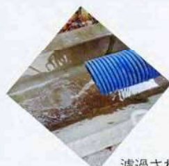
濾過された水
