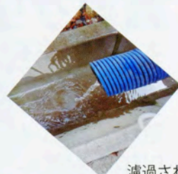
濾過された水
